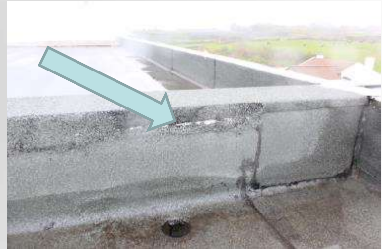
Problemas na impermeabilização de elementos emergentes
