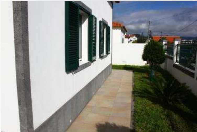
Parede de pano simples, com chapas em pedra, sem qualquer tipo de proteção, que evite a absorção de água.
