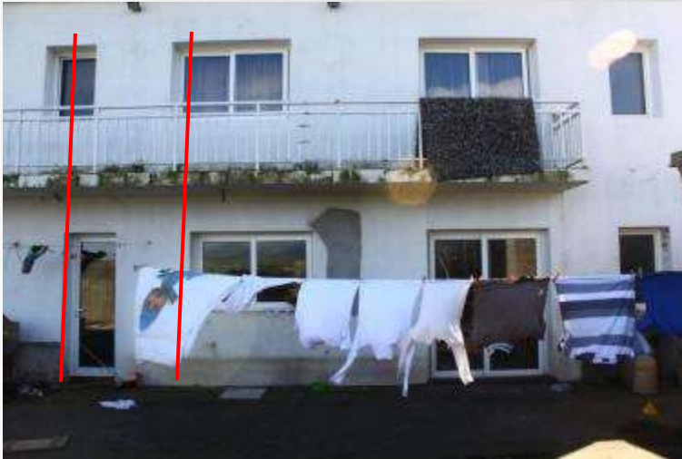
Vãos desalinhados. Falha de marcação / Leitura de projeto..
