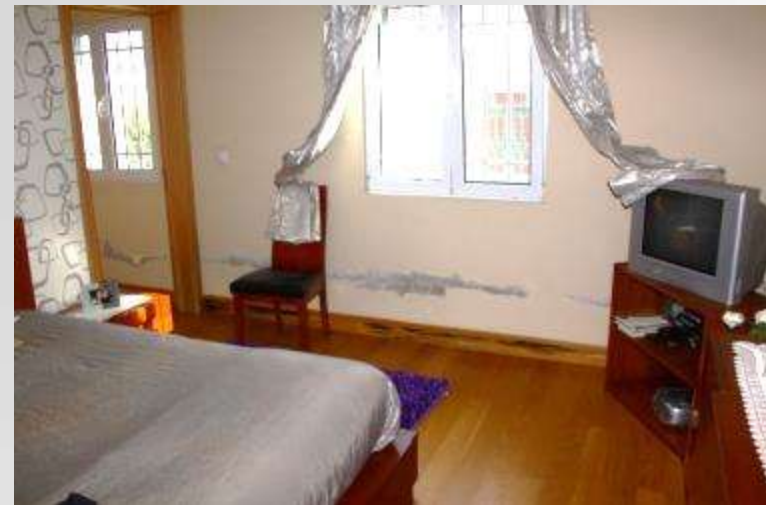
Resultado: Humidade no interior da moradia pouco tempo depois da conclusão da construção (menos de 1 ano).
