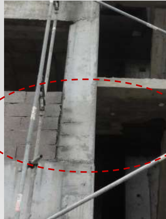
Elemento de secção regular. Espaçadores não foram colocados..
