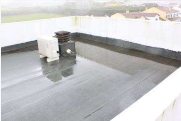
Pendentes reduzidas / Acumulação de água
