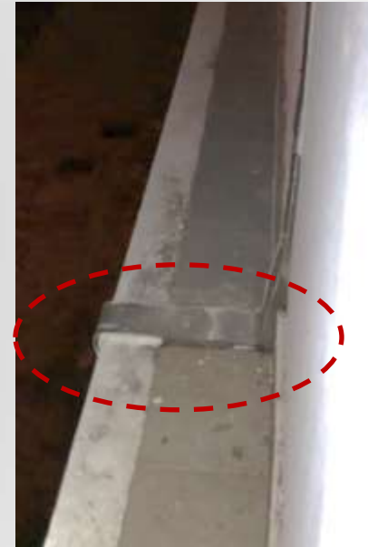
Ligação entre chapa e base com argamassa (rígida). Apresenta zonas por preencher, que permitem a infiltração de água soprada.
