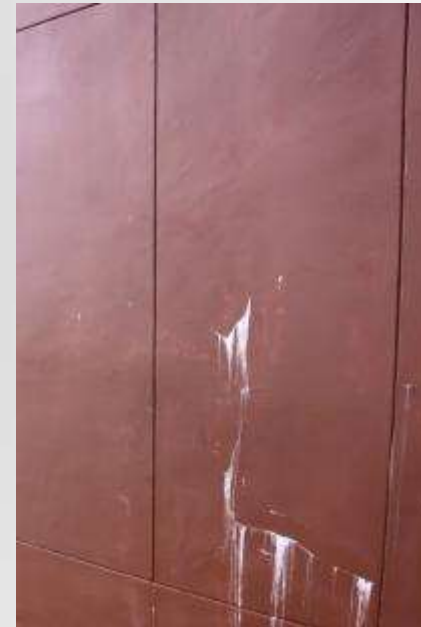
Improviso de “capoto”. Fissuração em reboco aplicado sobre placas de poliestireno extrudido (XPS), apesar de alhetas. XPS é muito rígido.
