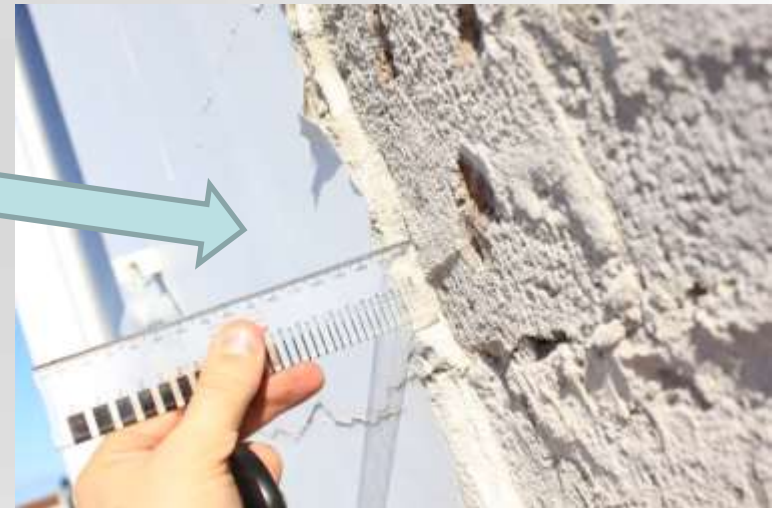
Reboco de resistência muito reduzida (friável) e com espessura entre 1 a 1,5cm.
