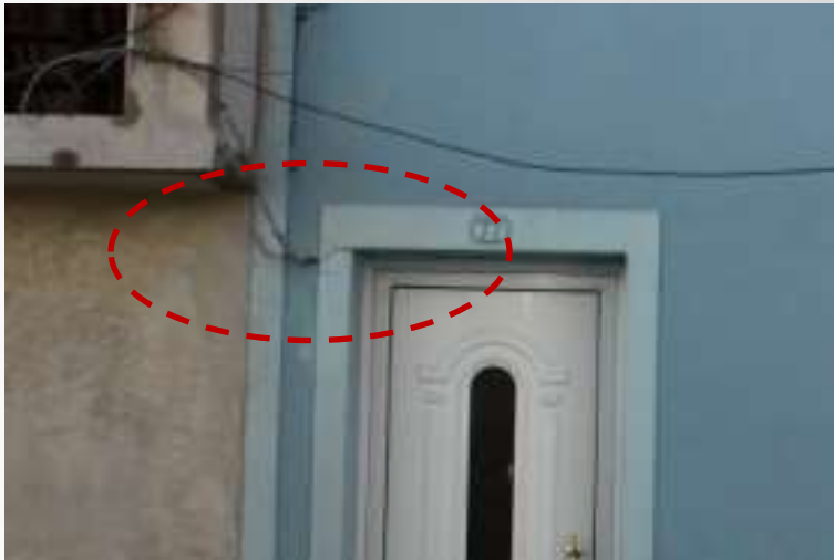
Fissuração em ombreira ,compatível com o descalce e descompressão lateral da moradia.
