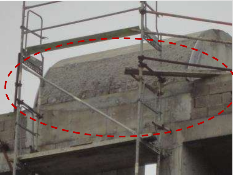
Armadura à vista em laje curva.
