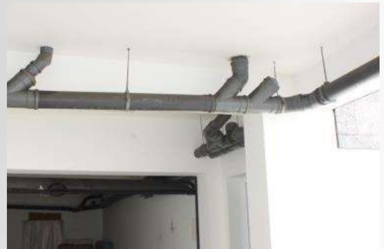
Furos em elementos estruturais para passagem de tubagem. Coordenação de projeto é importante para evitar estas situações.
