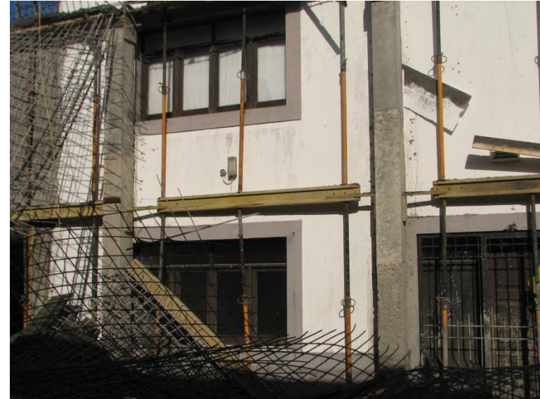
b) Escoramento após o colapso da cofragem.
