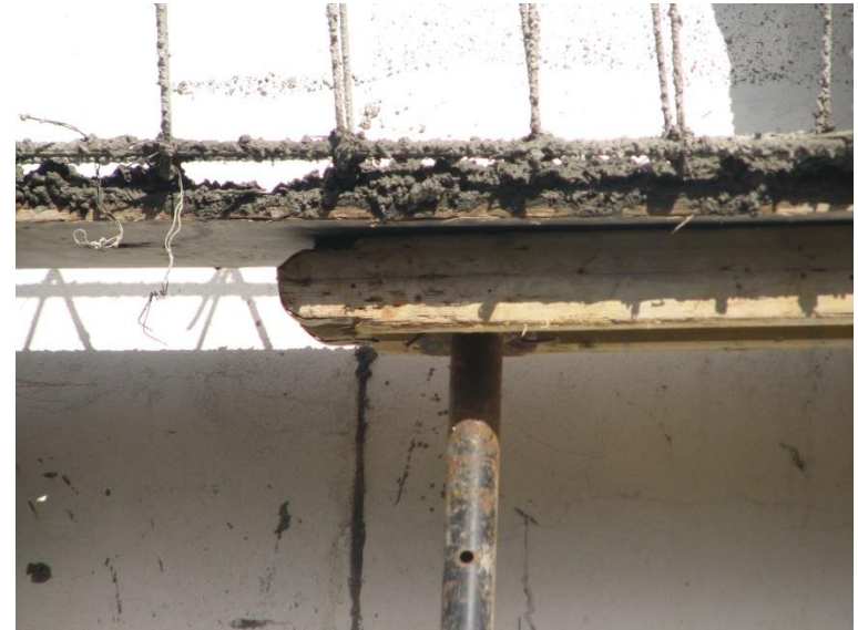
b) Descontinuidade em apoio de cofragem da viga.
