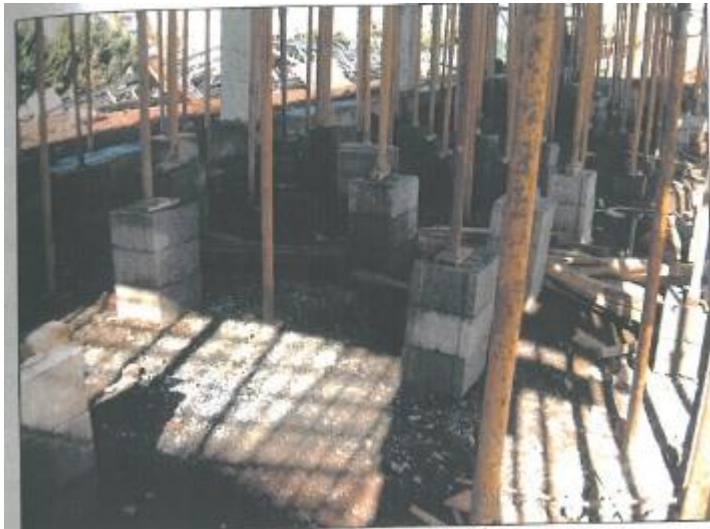
a) Escoramento antes do colapso da cofragem.
