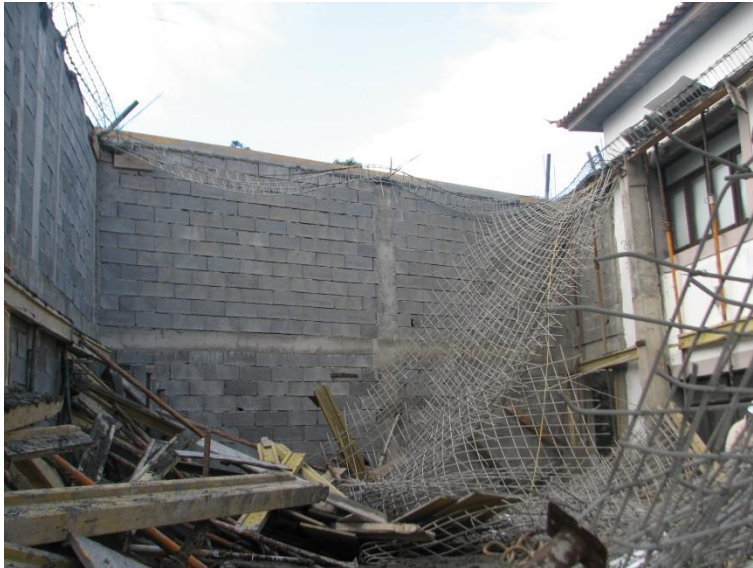
a) Escombros após o colapso da cofragem.
