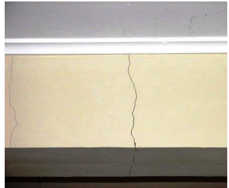
b) Fissuração na viga.
