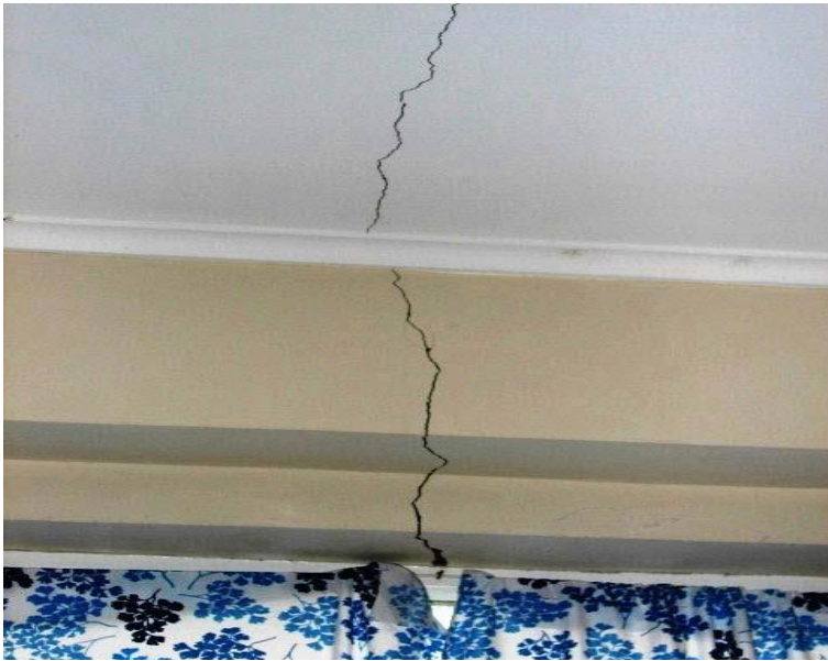
a) Fissuração na viga e laje.
