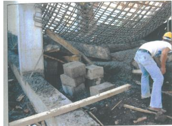
b) Escombros sob a laje após o colapso da cofragem.
