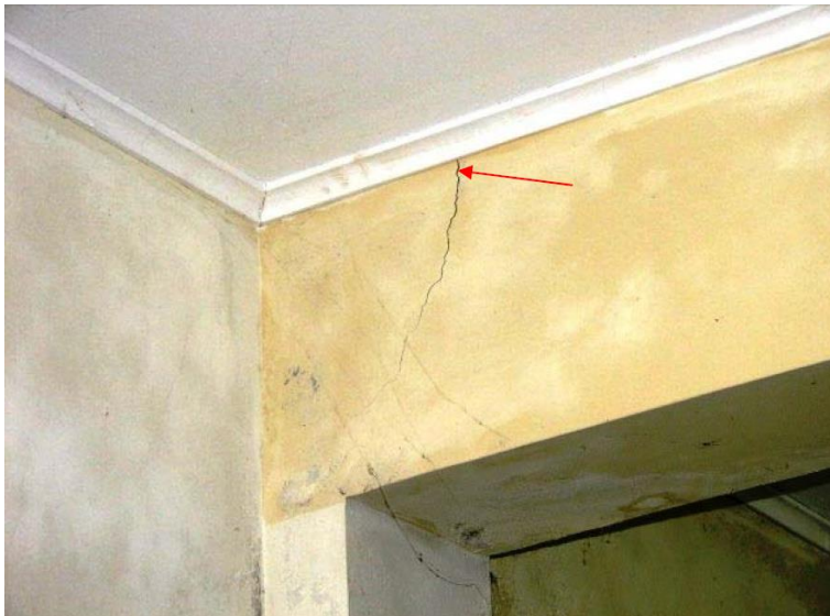
a) Fissuração na zona do apoio.
