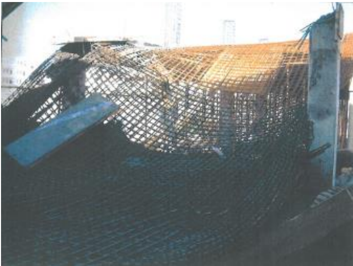
a) Colapso da cofragem durante a betonagem.
