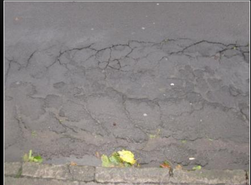
Rutura do pavimento
