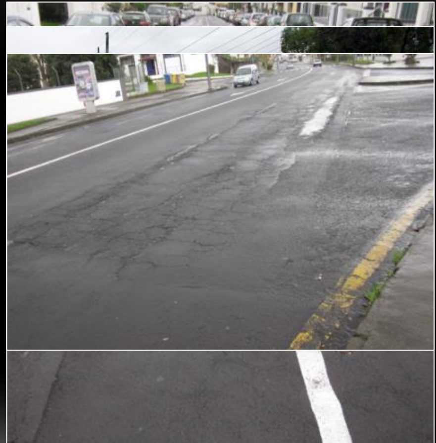
Irregularidade no pavimento
