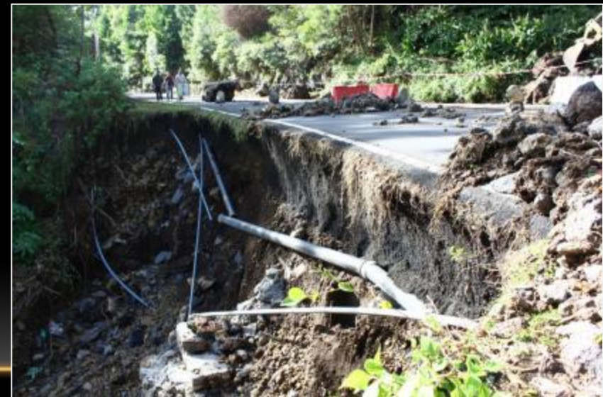
Entupimento de passagem hidráulica, na estrada Regional das Ribeiras – Lajes (Ilha do Pico)
