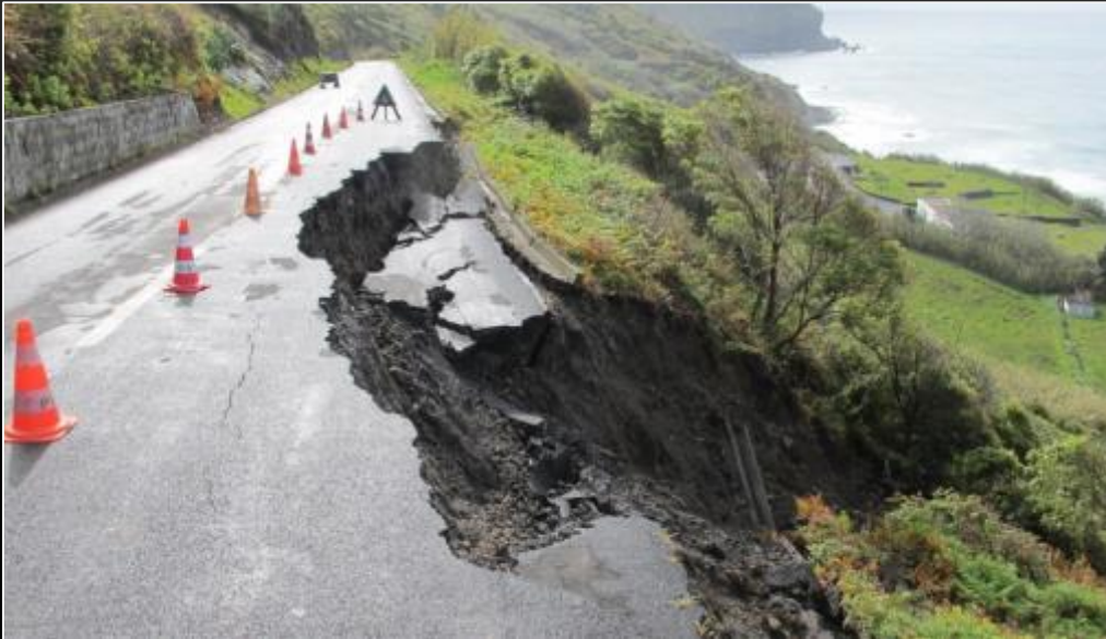
Deslizamento rotacional com rotura progressiva afetando uma das faixas de rodagem da via de comunicação Praia Formosa-Malbusca, Ilha de Santa Maria
